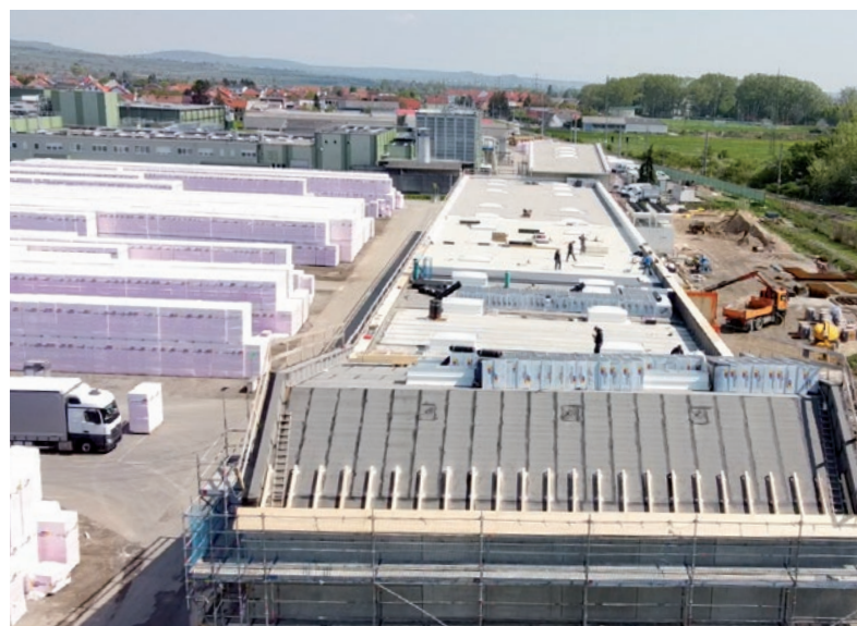
Am Dach wurde das besser dämmende graue Austrotherm EPS® W25-PLUS, teils als Gefälledach, mit einer Dämmdicke bis zu 26 cm verbaut.
