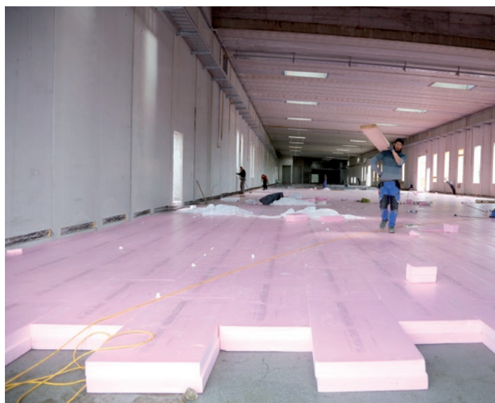
Das hochbelastbare Austrotherm XPS® TOP 50 dämmt den Boden der neuen Produktionshalle. Die Fußbodenheizung wird mittels Bauteilaktivierung energiesparend durch die Abwärme der Produktionsanlagen betrieben.
